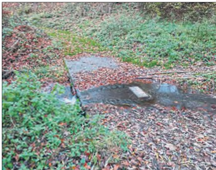
Die Wiederherstellung der ökologischen Durchgängigkeit ist erforderlich. Viele Wasser-Lebewesen können versiegelte Bachsohlen und Betonstufen nicht überwinden.
